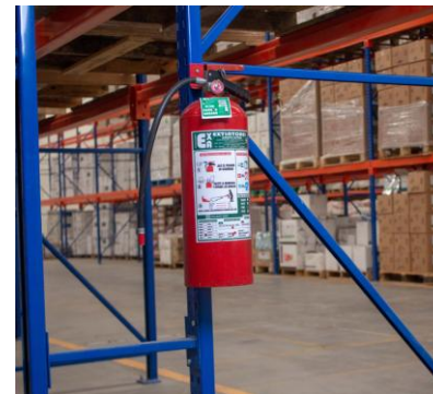
Extintores (químicos) para el tamaño del almacén.
