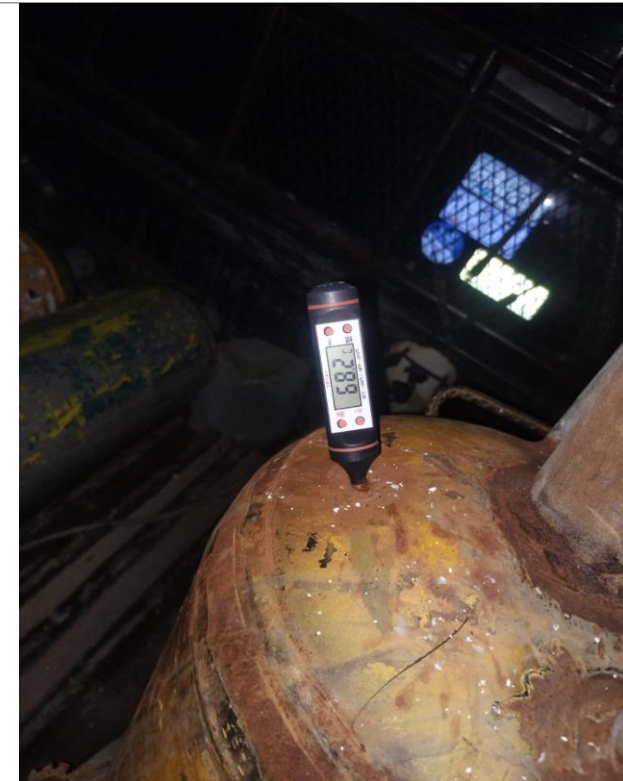
Temperatura del evaporador
