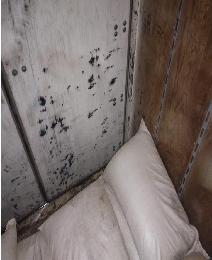
Inspección de la hermeticidad
